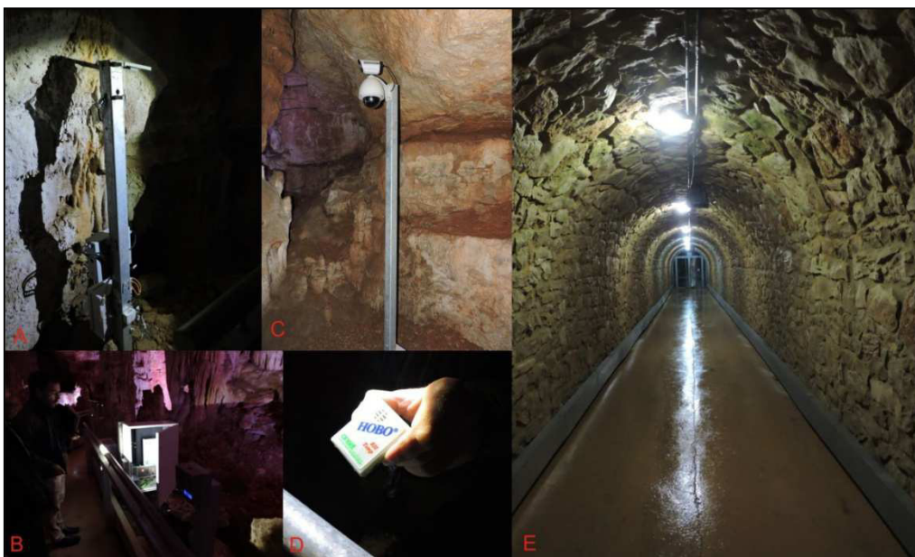
Figura 3.10 - A e D: Equipamentos que coletam os dados para monitorização. B: Painel de controle de luzes internas. C: Câmera de controle interno. E: Entrada construída, vista para uma das três portas existentes.
