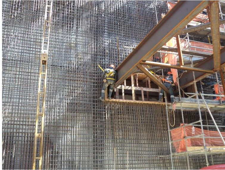
Figura 15 – Funcionários realizando atividade em altura (reproduzido da base de imagens do NSHT, 2017).
