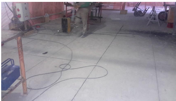
Figura 13 – Cabos elétricos expostos a impactos mecânicos (reproduzido da base de imagens do NSHT, 2017).
