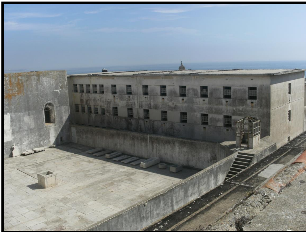
Fig. 36 – Bloco Prisional da Fortaleza de Peniche, em evidente estado de degradação.
