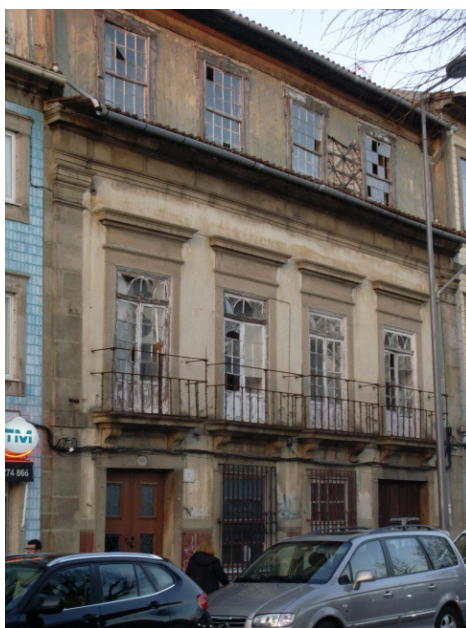
Figura 137 – Casa devoluta no lado Norte da Avenida Central (nº 36)
