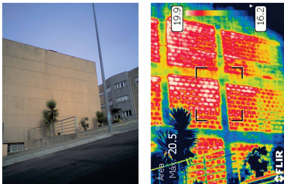
Figura 5 – Termografia na fachada sul do edifício
