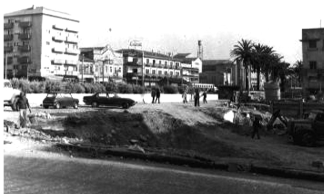
Fig. 10 – Demolição do quarteirão onde se situava a Casa dos Souza Cardoso, maio-junho de 1973. (Col. particular).
