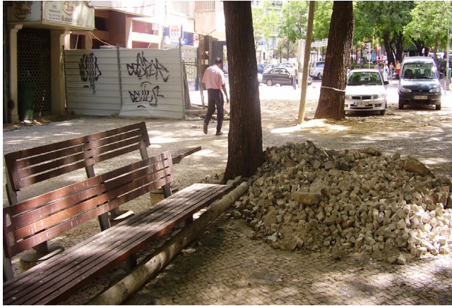
Figura 2: Vedação em mau estado e materiais depositados no espaço público sem qualquer sinalização
