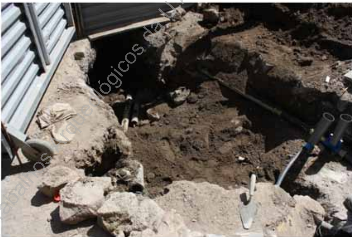
Foto 117 – Abertura da vala para implantação dos tubos de abastecimento de água pela AGERE e de energia elétrica pela EDP.
