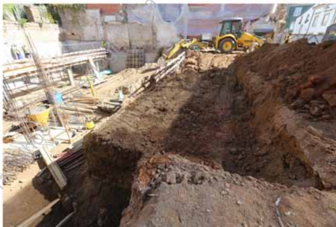
Foto 15 – Início dos trabalhos de desaterro na área sul junto à fachada da casa.
