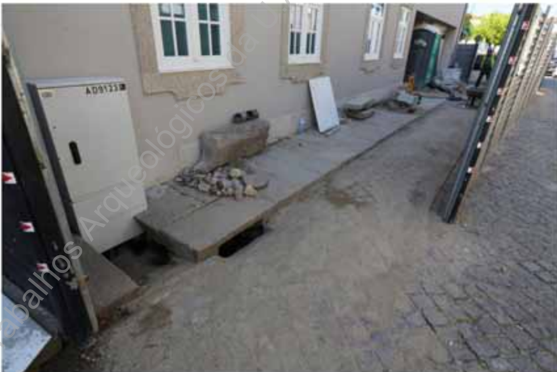
Foto 121 – Registo do calceteamento das valas dos tubos da AGERE e EDP e da implantação da caixa de distribuição da energia junto à fachada da nova habitação.
