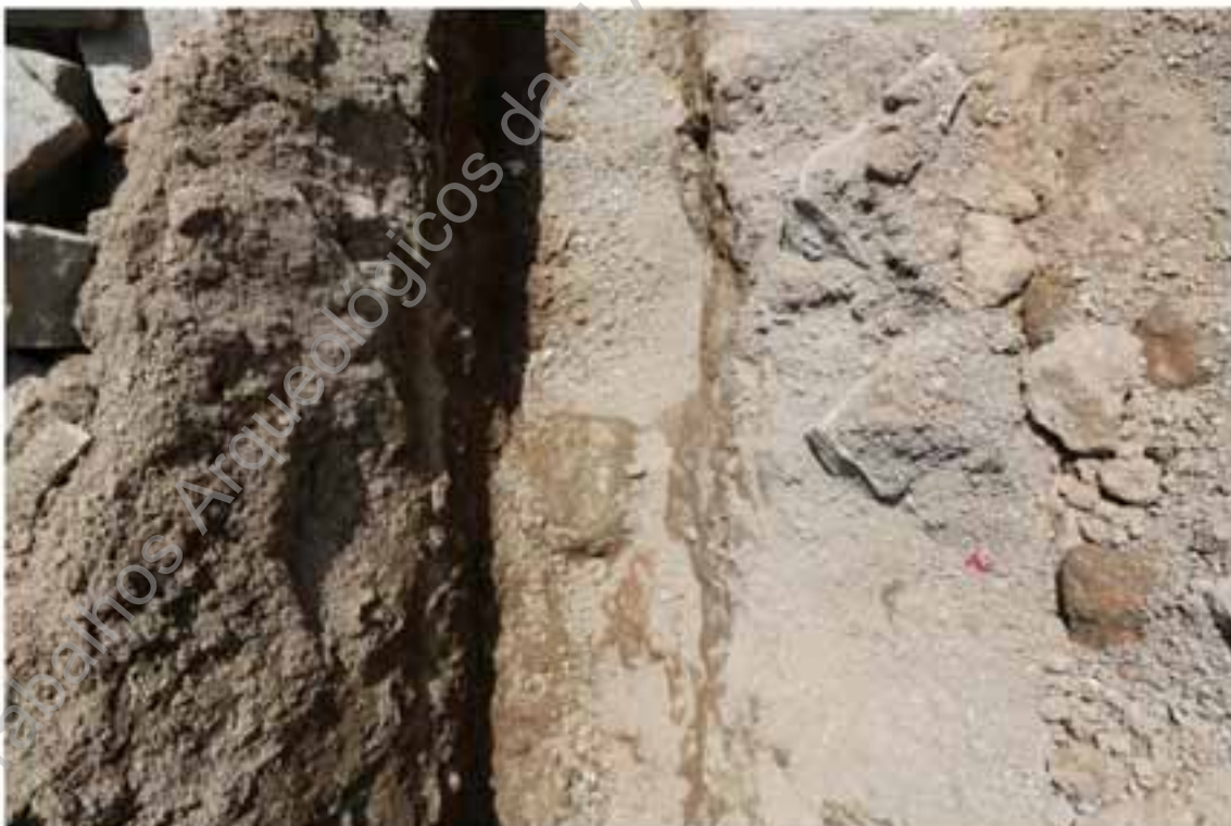
Foto 119 – Registo de uma sapata durante a abertura da vala para implantação dos tubos de abastecimento de água pela AGERE e de energia elétrica pela EDP.
