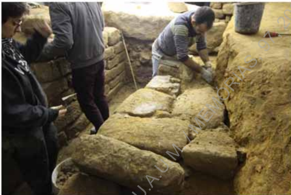
Foto 73 – Trabalhos de restauro de parte dos alçados da cloaca com blocos graníticos provenientes do derrube da própria estrutura.
