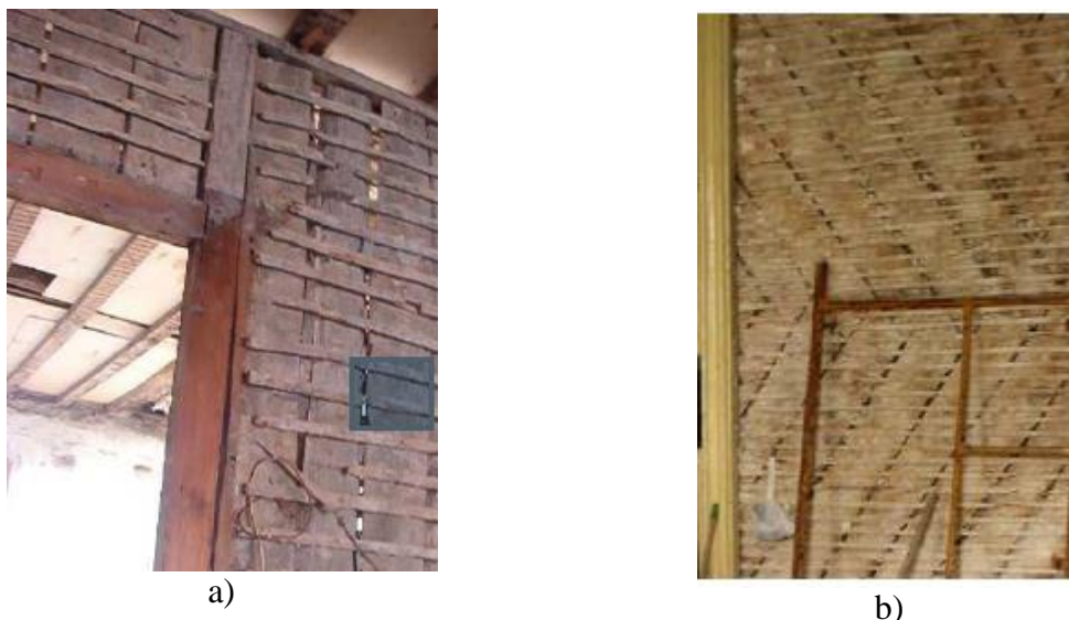
Figura 6 – Paredes em tabique: a) Tábuas na vertical; b) Tábuas na diagonal (Pires, 2013)
