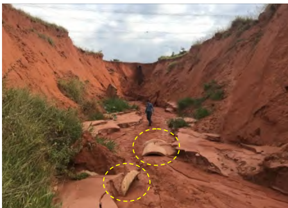
Figura 6: Rede de drenagem de águas pluviais danificada presente no interior da feição. Fonte: Elaborado pelas autoras.
