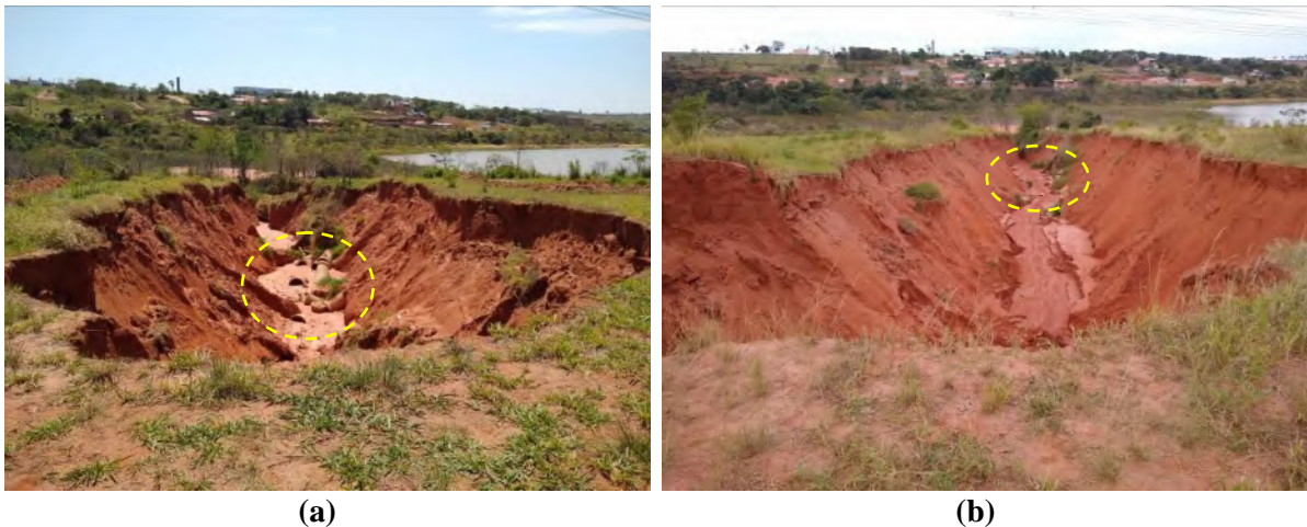
Figura 9: Vista do interior da ravina, mostrando o formato em “V” e a evolução com o tempo: (a) na primeira vistoria, em setembro de 2019; (b) na segunda vistoria, em abril de 2020. Destaque para a localização dos tubos.
