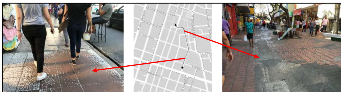
Fig. 4 Pavimentação derrapante e degradada
