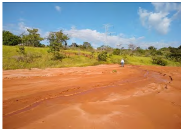
Figura 7: Sedimentos carreados devido ao processo erosivo. Fonte: Elaborado pelas autoras.
