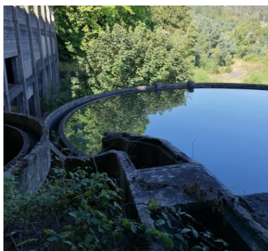
Figura 32 - Depósito de água 2020)
