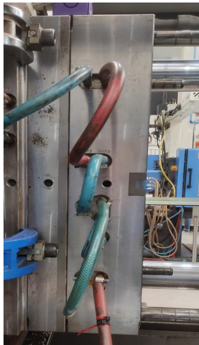
Figura 27- Sistema de entrada e saída de água do lado de injeção conectado por manueiras
