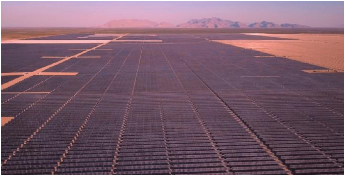
Figura 1-9 - Parque solar PV Villanueva, México (Fonte: Portal da Energia, 2020, [16]).
