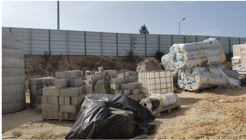
Figura 44 - Falta de organização e identificação de materiais
