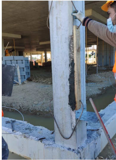
Figura 43 - Má execução de pilar
