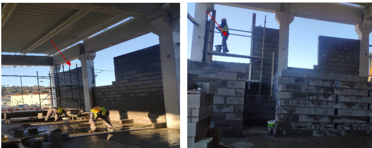
Figura 35 - Erro de execução de parede de alvenaria
