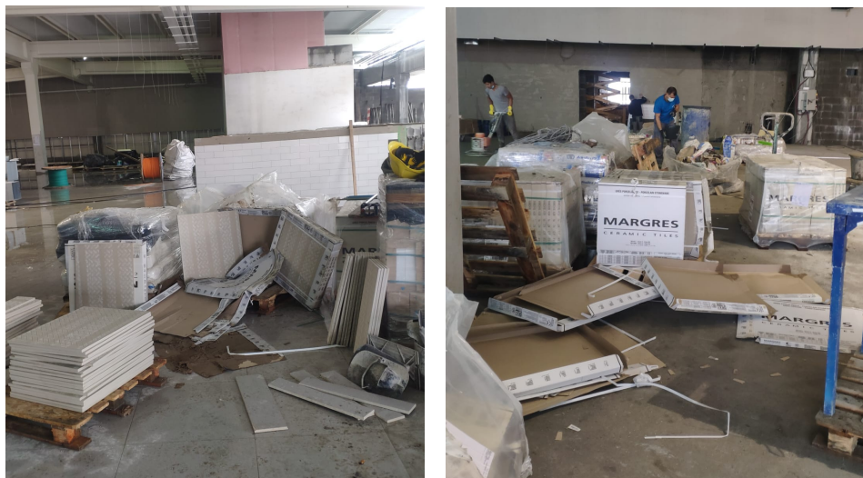
Figura 38 - Desorganização e falta de limpeza do espaço de trabalho na atividade de assentamento de cerâmicos
