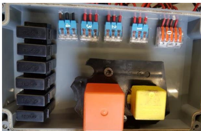
Figura 56. Fotografia da caixa de relés, fusíveis e barramentos – numerados de 0 a 4.
