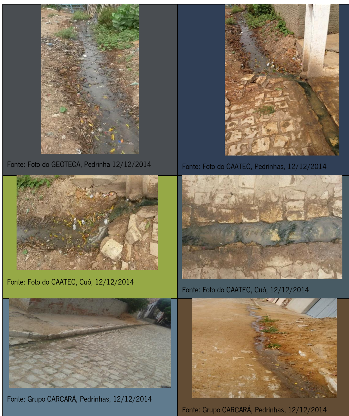
Figura 26. Esgotos a céu aberto existentes nas comunidades de Ipanguaçu/RN
