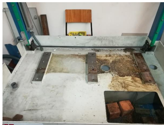
Figura 5.20 - Estado de conservação da estrutura da base.
