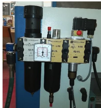
Figura 5.36 - Unidade de tratamento do ar comprimido do centro de maquinagem.
