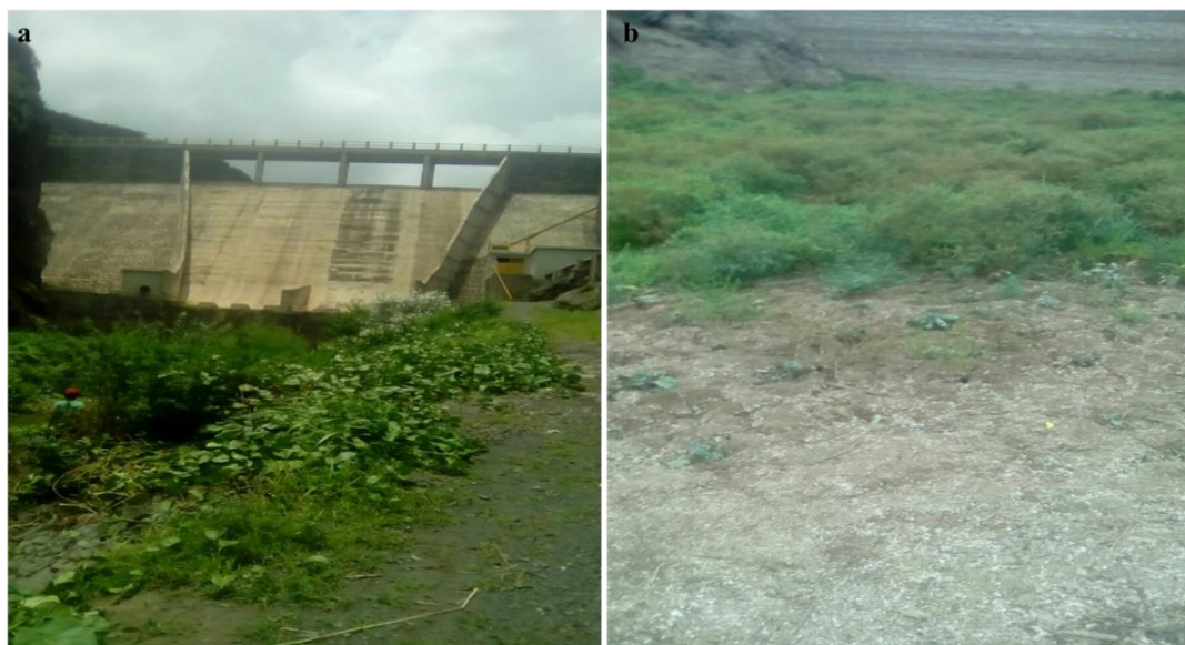
Figura 47- Barragem de Figueira Gorda e o seu estado atual (a- estrutura da barragem; b- albufeira seca)
