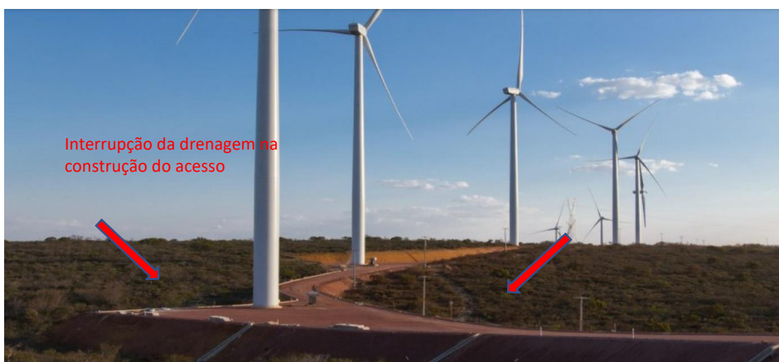
Figura 118: Impactes ambientais em Áreas de Preservação Permanente – APP na construção do acesso. Fonte: Goetze lobato Engenharia S.A., disponível em https://www.gel-eng.com.br/ , acesso em novembro de 2020.
