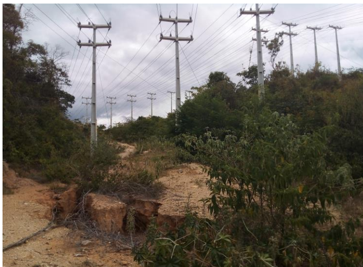
Figura 98: Erosão na área de construção das redes elétricas de média tensão para parque eólico, no município de Caetité. Fonte: Autor (2020)
