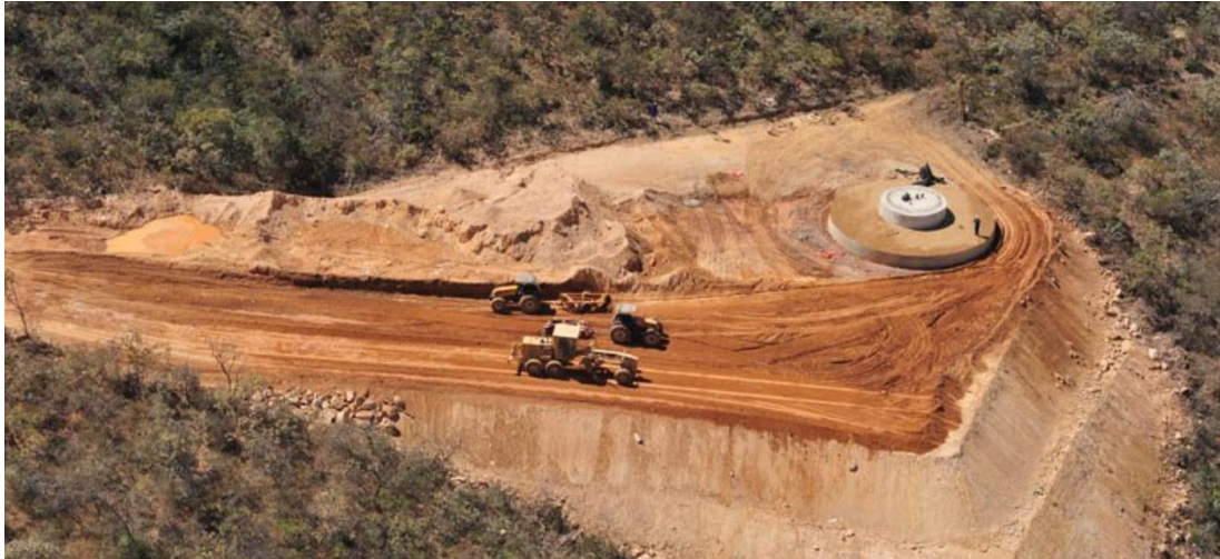
Figura 116: Erosão e compactação do solo me parque eólico na Bahia, em 2014. Fonte: Goetze Lobato Engenharia S.A., disponível em https://www.gel-eng.com.br/ , acesso em novembro de 2020.
