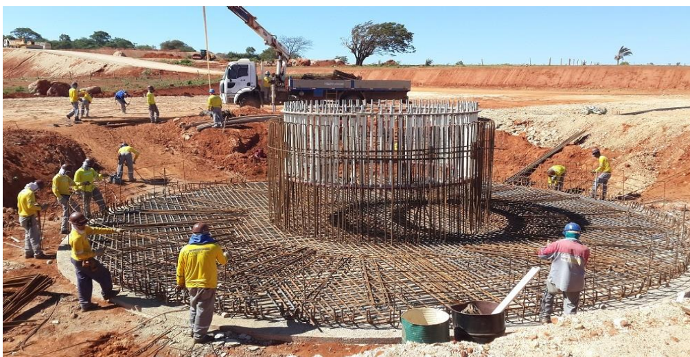
Figura 89: Postos de trabalho temporários. Concretagem da fundação para instalação de aerogerador da empresa Brazil Wind no município de Caetité em 2012 / 2013. Fonte: BRAZIL WIND (2013).
