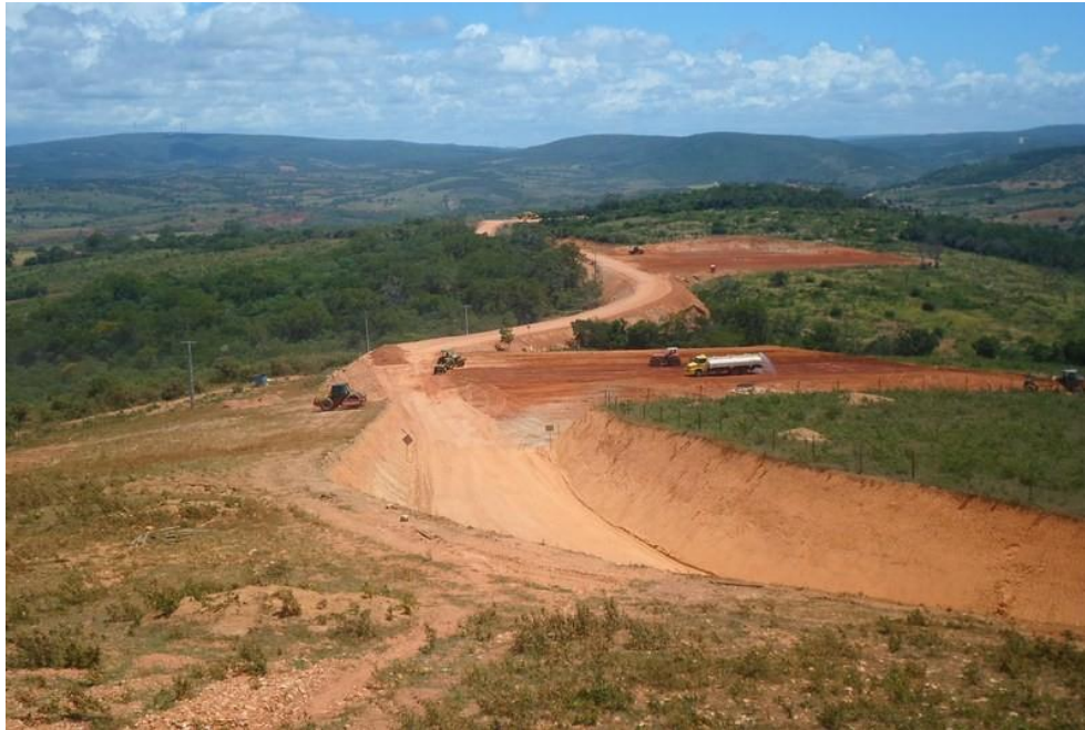
Figura 104: Preparação do Terreno, em área de topo de morro, para a instalação de Parque Eólico no município de Caetité em 2012 / 2013. Fonte: BRAZIL WIND (2013).
