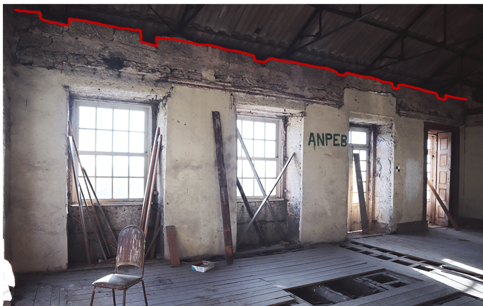
Figura 67 e 68: Marcas da cobertura original da Casa Martins Sarmento;
