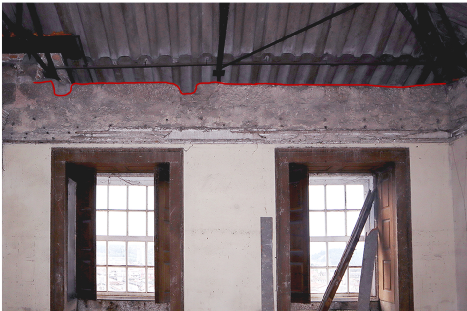
Figura 64 e 65: Marcas da cobertura original da Casa Martins Sarmento;
