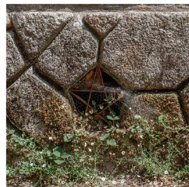
SISTEMA DE VENTILAÇÃO
