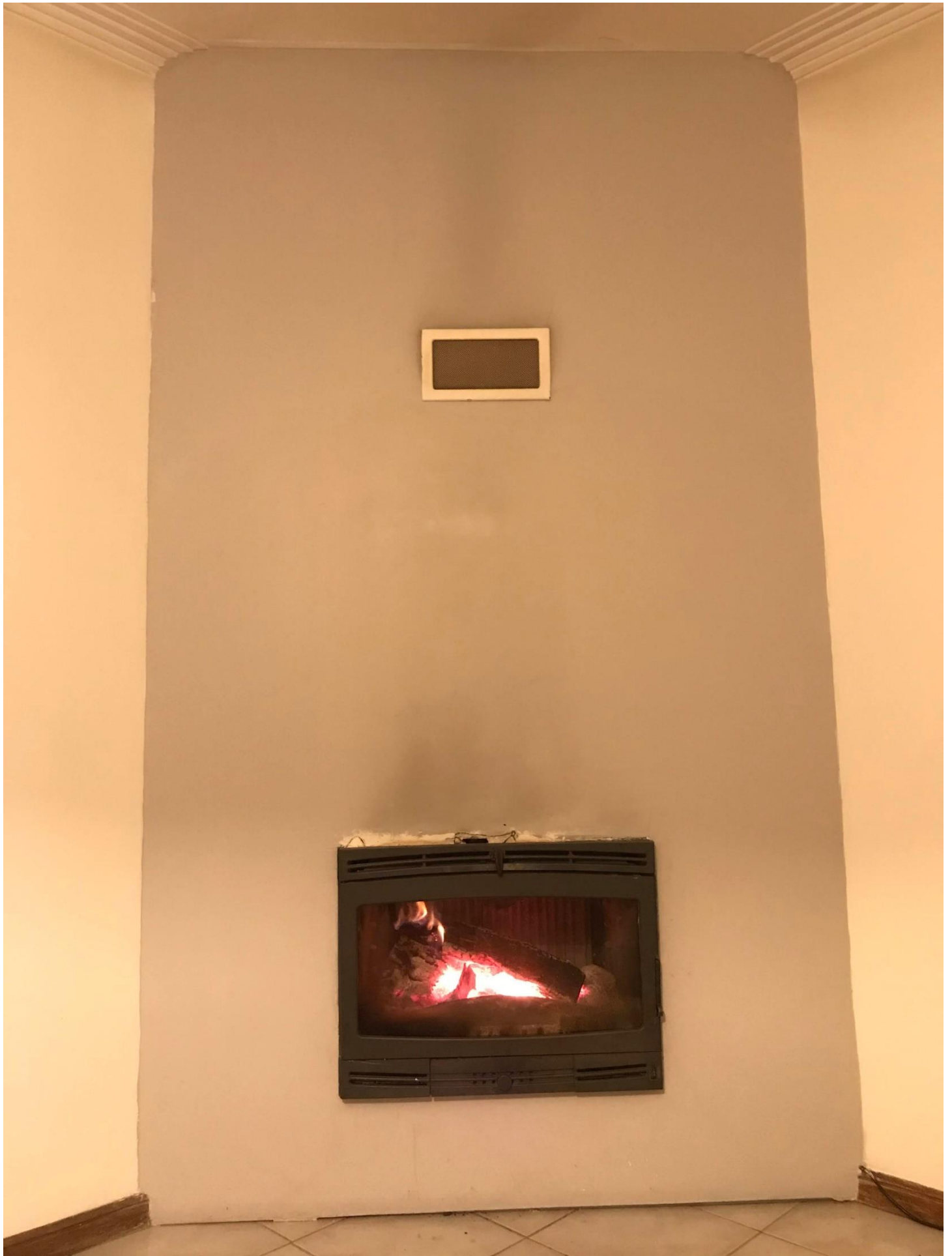
Ilustração 106 - Patologia na parede de pladur no contato com a aresta superior do recuperador de calor
