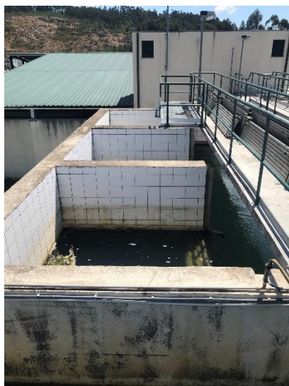
Figura 8. Tanque repartidor de caudais.
