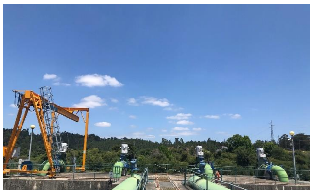
Figura 3. Grupos eletrobomba responsáveis pela captação de água.
