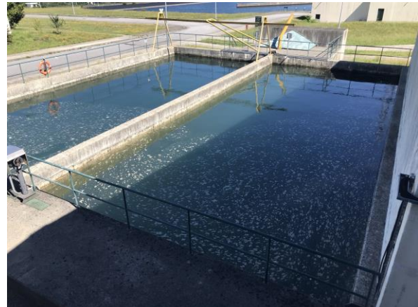
Figura 11. Cisterna de água de lavagem de filtros.
