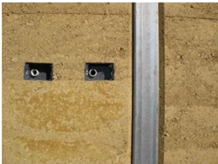
Figura 2.20 - Exemplo de detalhe de instalação elétrica embutida (Foto de Rodrigo Rocha, 2015)
