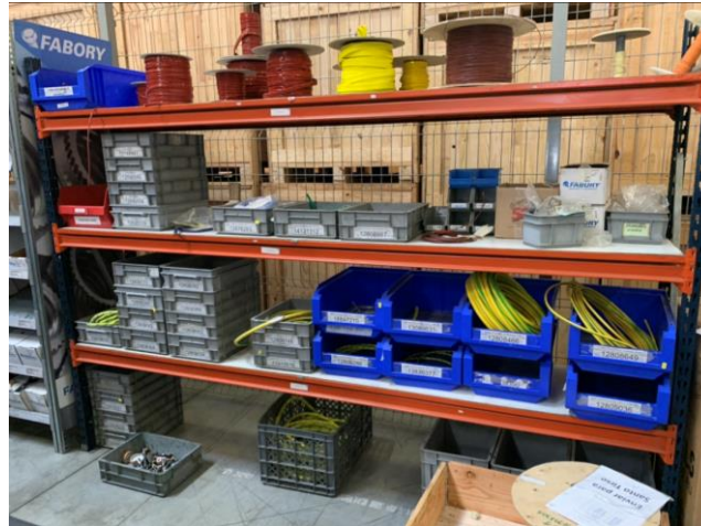
Figura 40 - Armazenamento inadequado dos cabos e mangas
