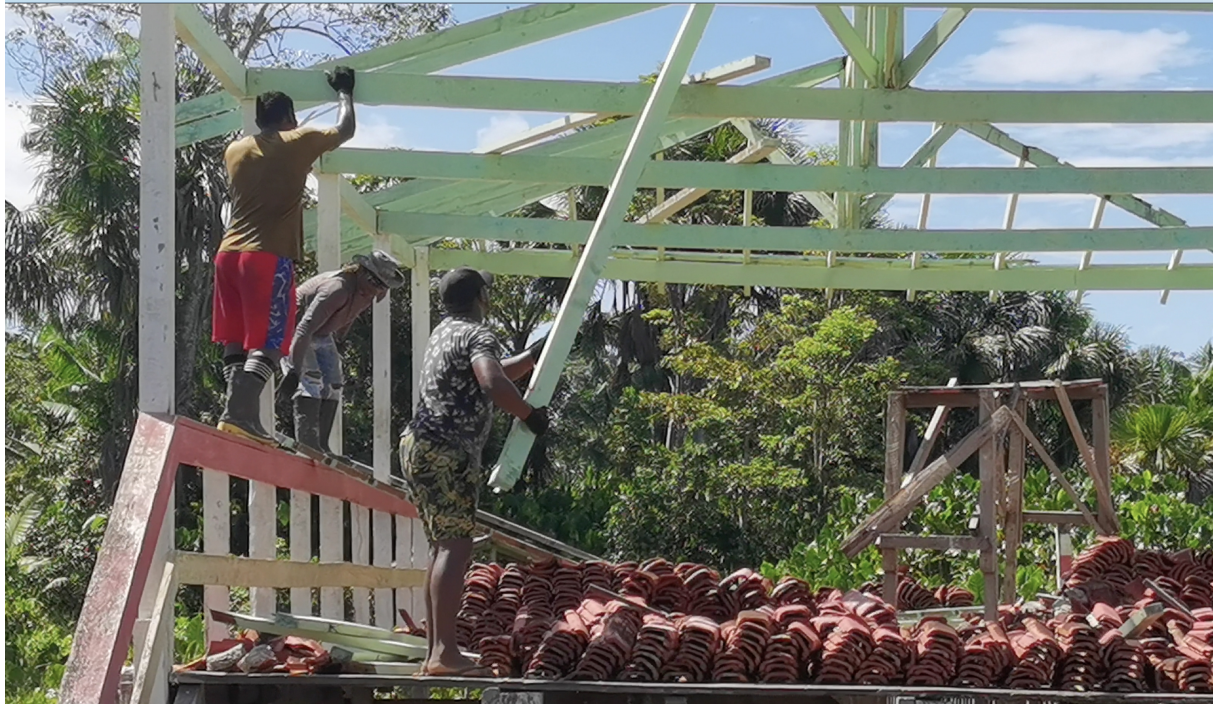
Figura 1. Mazagão Velho 2022. Trabalhadores mazaganenses reformando telhado no trapiche do rio Mutuacá. Autor: Luiz Adriano Daminello. Julho/2022
