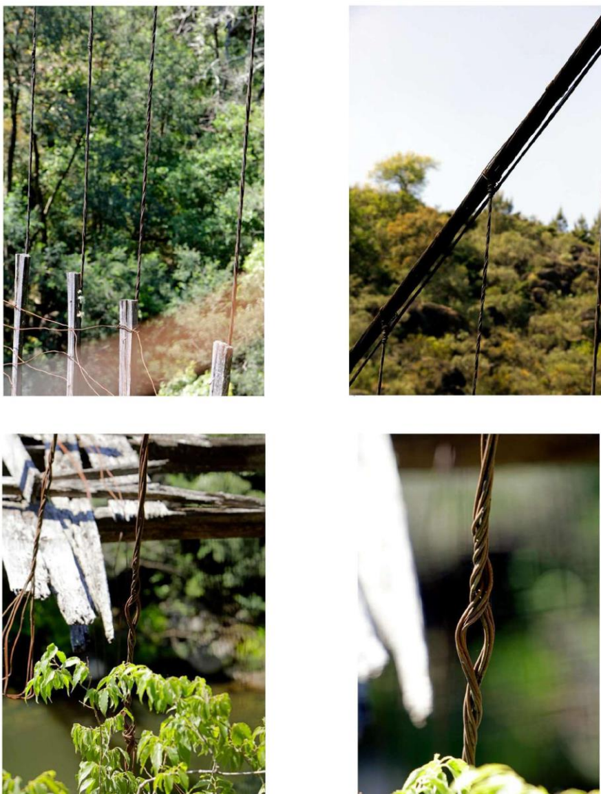
Figura 1.4 - Pormenores dos pendurais existentes
