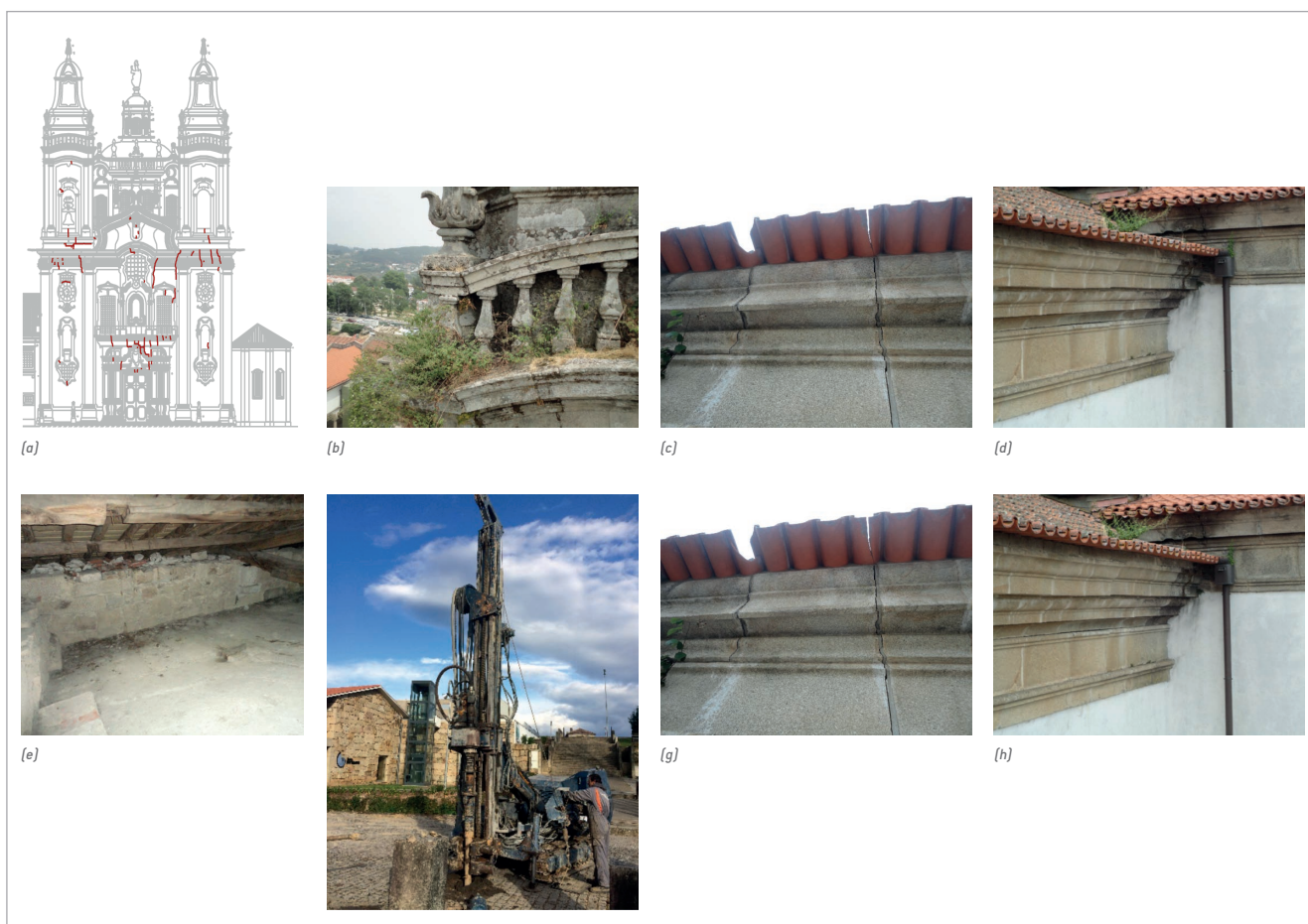
> Figura 2: Exemplos dos trabalhos e das anomalias identificadas no diagnóstico; (a) padrão de fendilhação; (b) vegetação nas torres; (c) reabertura de fendas e telhas do beiral partidas; (d) escorrimentos e caixas de tubo de queda preenchidas com vegetação e detritos; (e) zona da cobertura da nave sem asna de madeira; (f) sondagem geotécnica no exterior para realização de ensaios SPT e instalação de piezómetro; (g) poço de inspeção junto do cumhal sudoeste com nível freático próximo da cota do pavimento, (h) assoreamento da Ribeira de Penoutas com colmatção parcial da secção transversal do coletor de águas pluviais.
