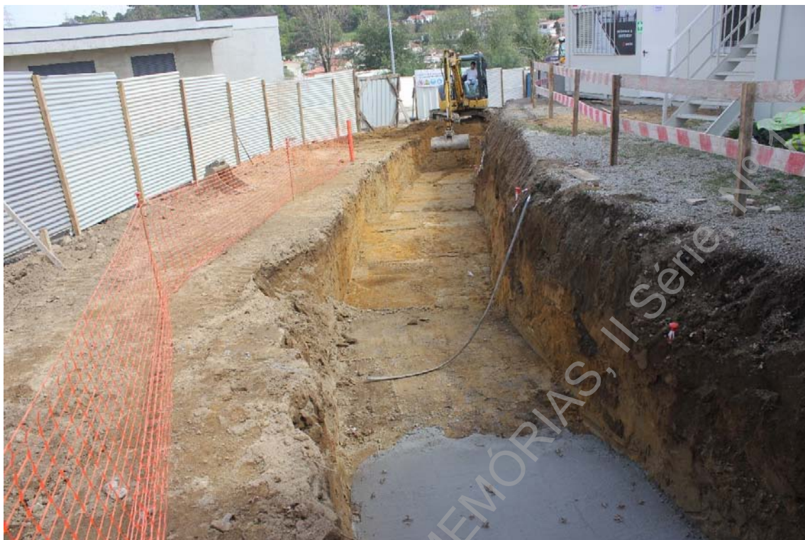
Foto 25 (IMG_6273) –Abertura da vala para a colocação das infraestruturas definidas no projeto de Arquitetura.
