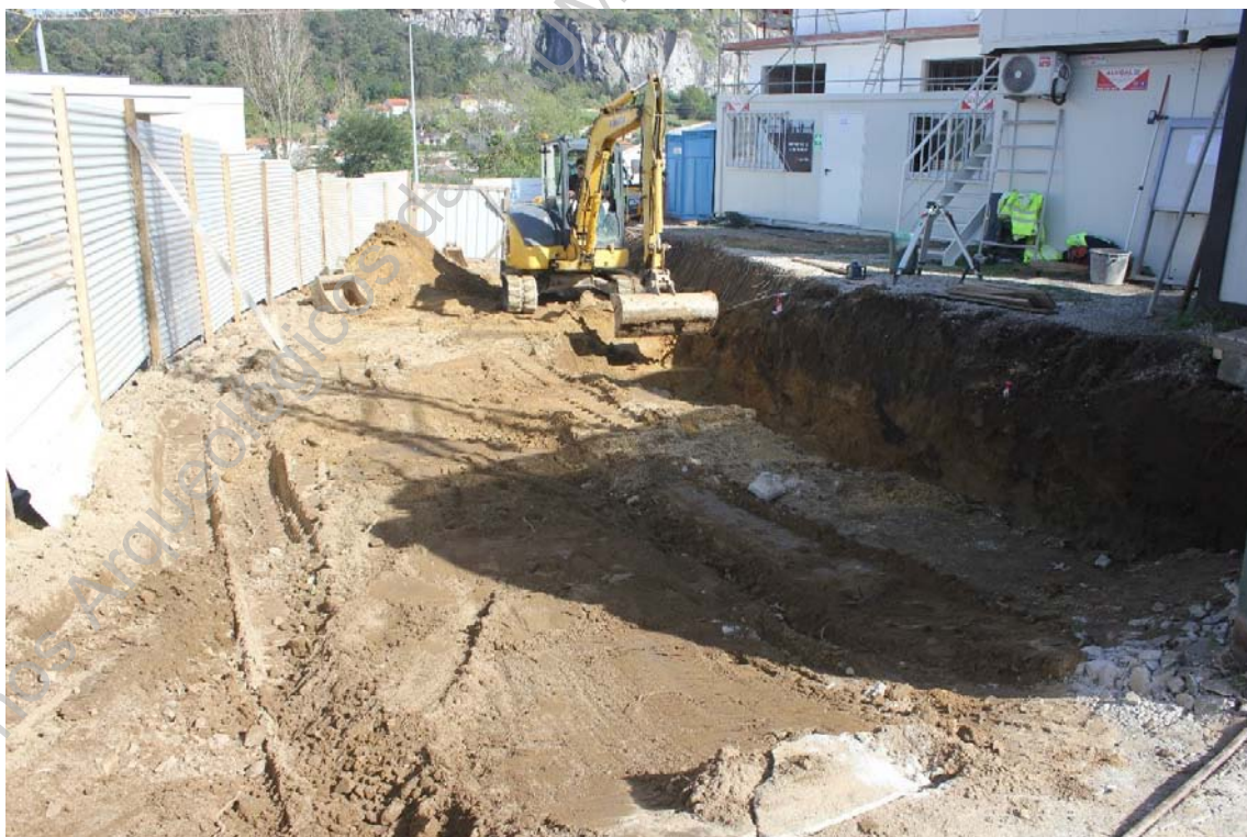
Foto 24 (IMG_6254) –Perspetiva geral da remoção de terras na área norte do lote.
