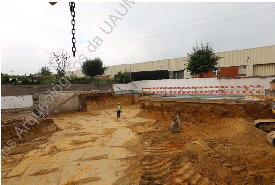
Foto 6 (IMG_2156) – Perspetiva geral da decapagem de terras realizada na área sudoeste do lote.
