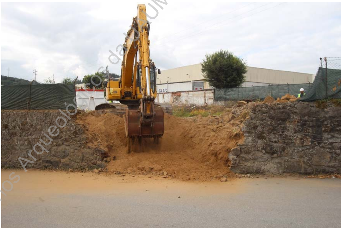
Foto 2 (IMG_4824) – Acompanhamento da abertura da rampa de acesso à rua dos Limoeiros.
