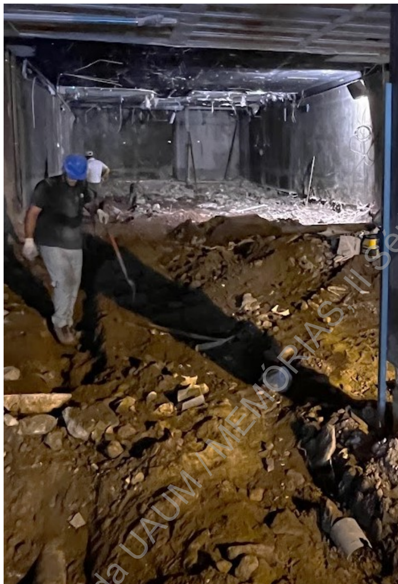
Foto 9 (IMG_8431) – Perspetiva geral da finalização do trabalho de remoção do piso do rés-do-chão.
