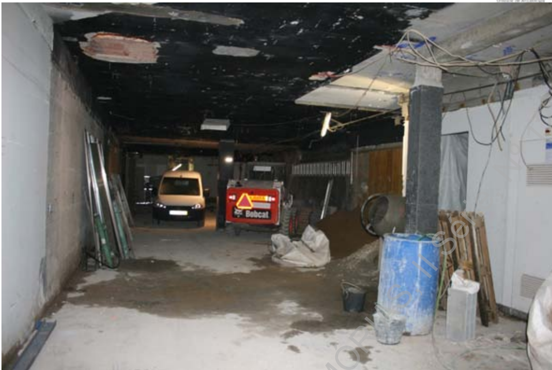
Foto 6 (IMG_5616) – Perspetiva geral da área a escavar no rés do chão do edifício.
