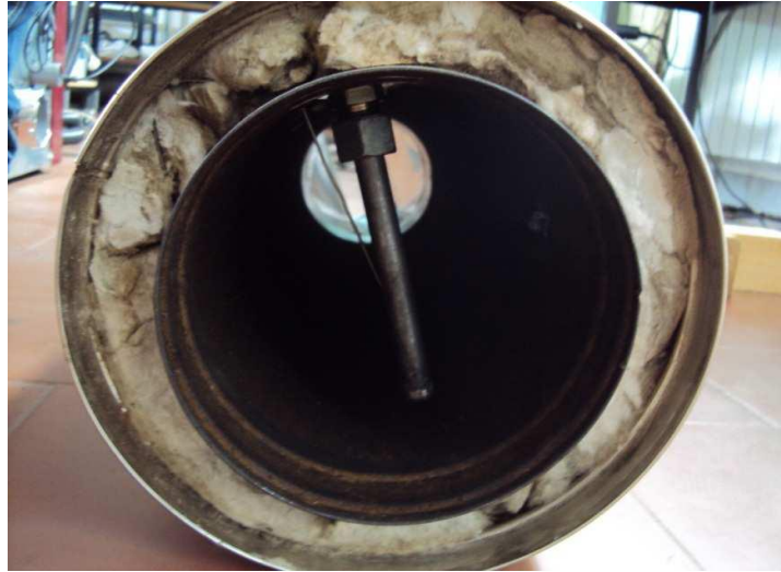
Figura 3.9 – Vista da sonda do pirómetro de aspiração montada na chaminé.
