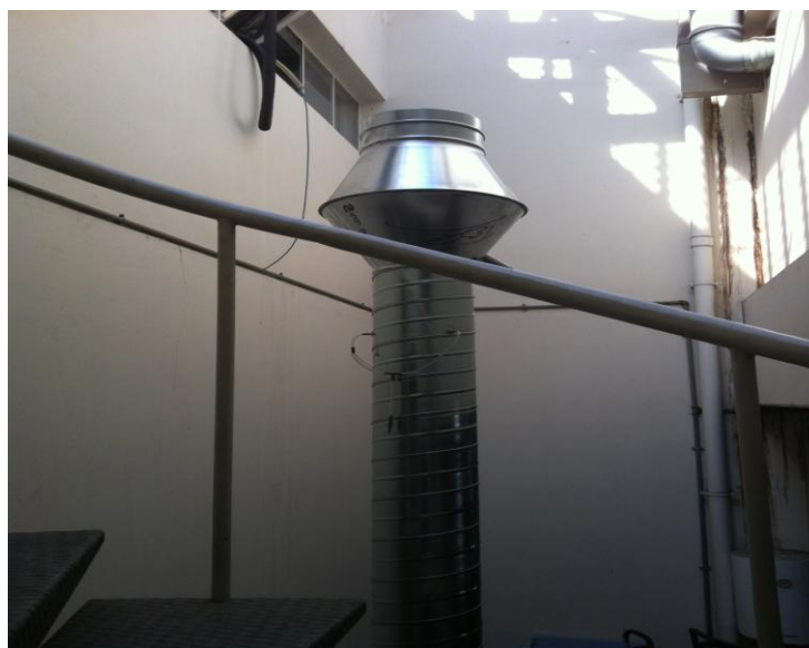
Figura 3-14: Tomadas de pressão na instalação do Chapéu Descarga Vertical
