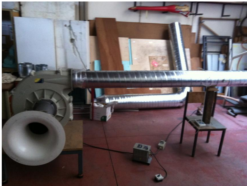
Figura 3-7: Variador de frequência acoplado ao ventilador
