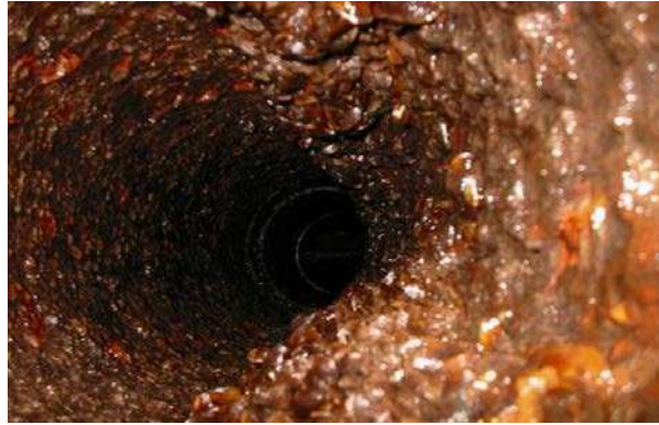
Figura 45 - Obstrução provocada pelos moluscos nas tubagens
