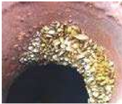
Figura 47 - Colonia de mexilhões em progressão numa tubagem
