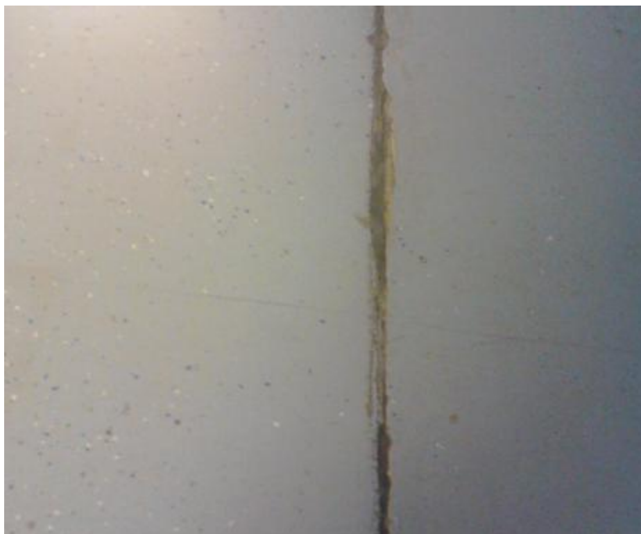
Fig. 23 - Patologia em Pavimento: Superfície Comercial, LIDL, Praga. Imagem captada pelo autor.
