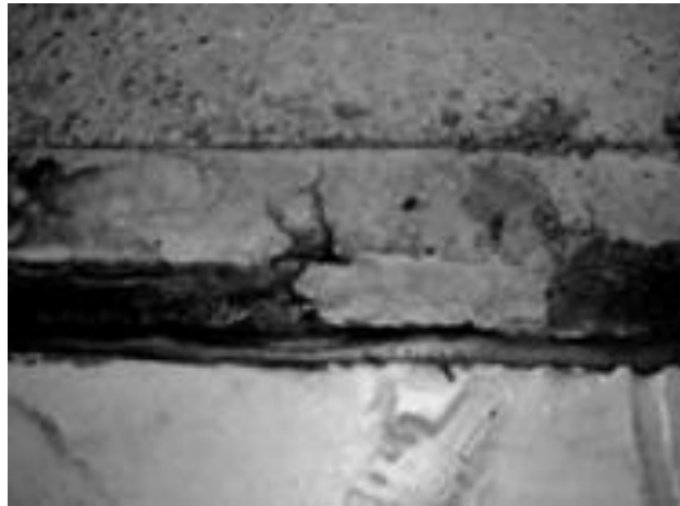
Fig. 18 – Caso 2: Apresentação de patologia em Junta para Diagnóstico. Imagem retirada do RILEM (24)
