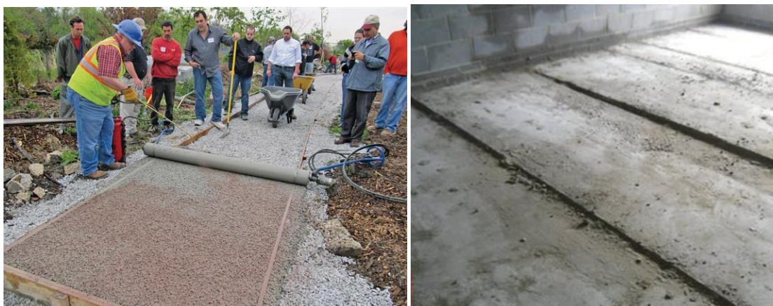
Fig. 8 - Uso de formas fixas para aplicação (esq.) e régua temporárias (dir.) para nivelamento e compactação de betonilhas de desgaste.
