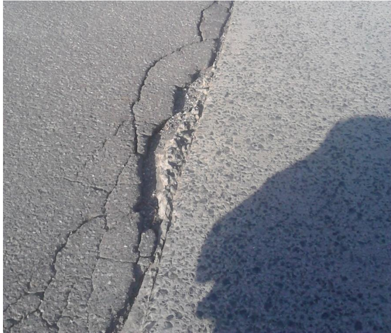
Fig. 22 - Patologia em Pavimento: Parque de estacionamento exterior do Instituto de Física de Praga (IOP), Rep. Checa. Imagem captada pelo autor.
