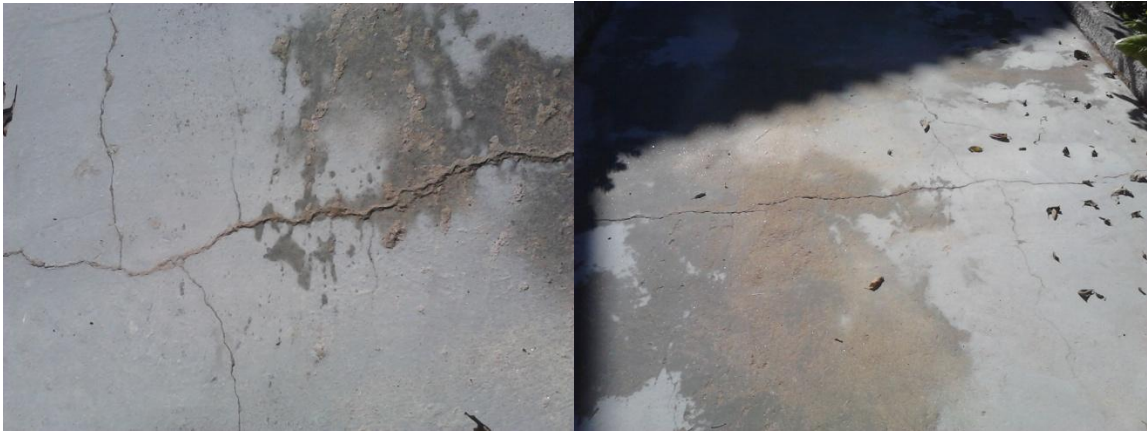
Fig. 20 - Patologia em Pavimento: Rampa de acesso, moradia Esposende. Imagem captada pelo autor.
