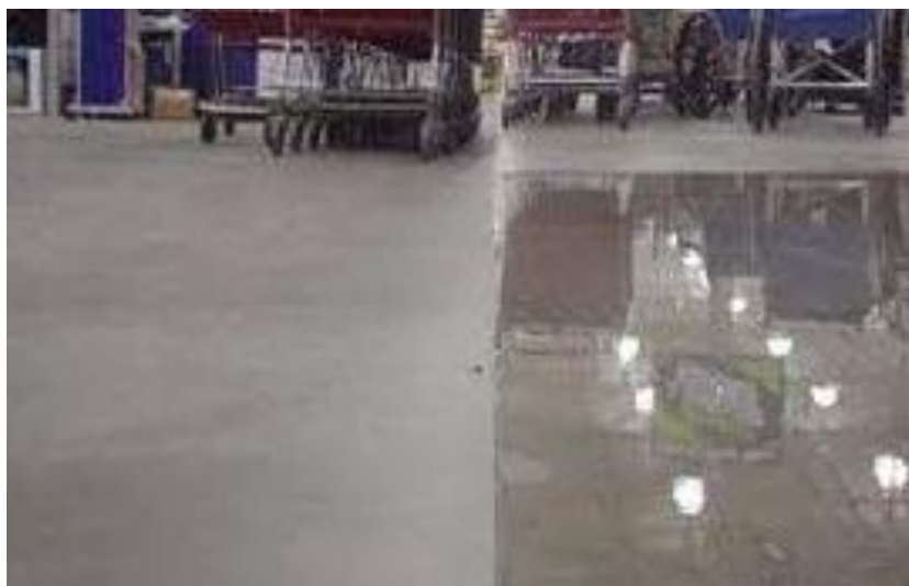
Fig. 9 - Piso onde foi aplicado um selante na superfície mais à direita.
