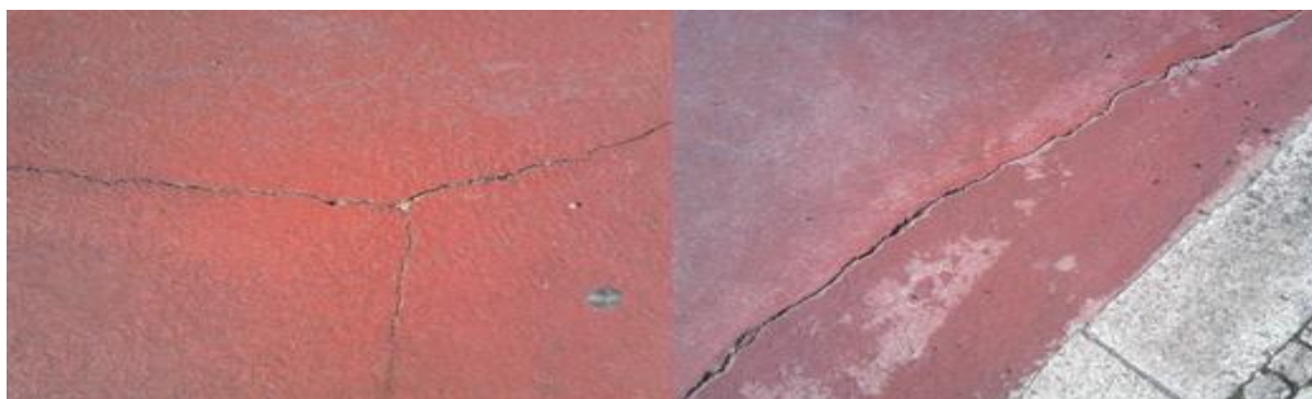
Fig. 19 – Caso 3: Ciclovia, situada na Marginal de Esposende. Pavimento em Betonilha com superfície pintada a vermelho. Imagem captada pelo autor.
