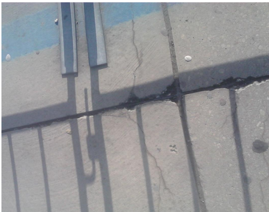
Fig. 21 - Patologia em Pavimento: Pista do Aeroporto de Praga, Ruzyně, Rep. Checa. Imagem captada pelo autor.
