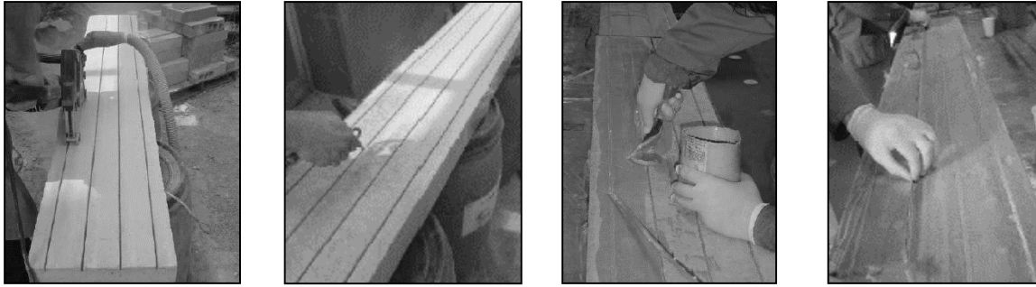
Figura 6 - Reforço à flexão com laminados de CFRP aplicados com a técnica NSM (Sena-Cruz, 2011).
