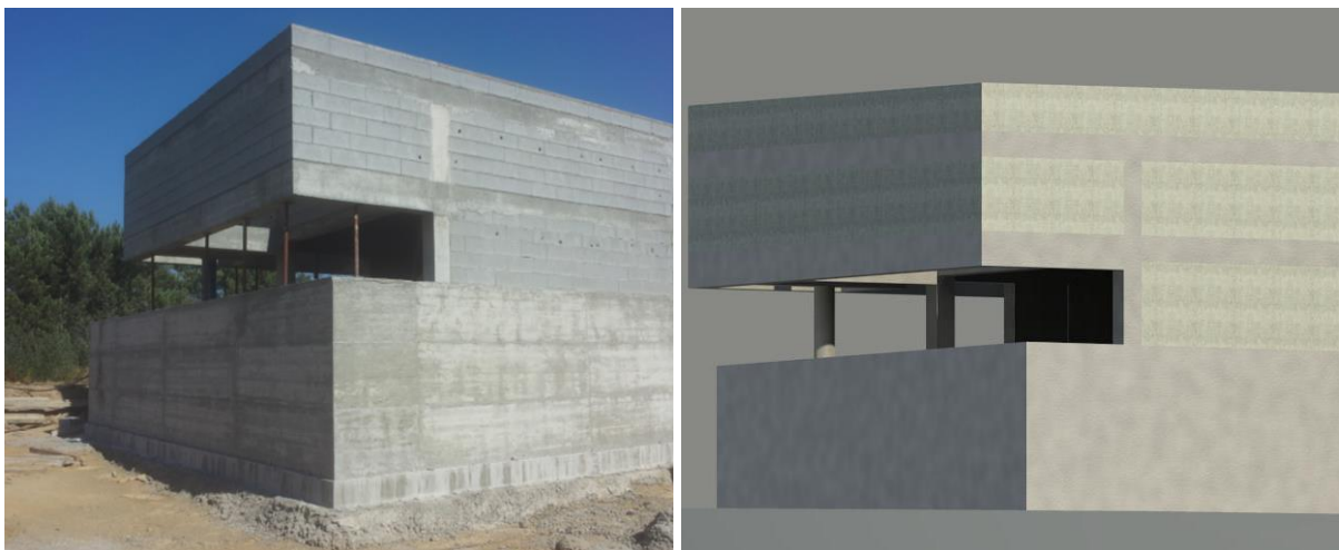
Figura 4.26 – Diferenças entre a obra real e o projeto de execução elaborado no software Revit
