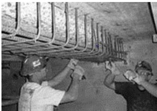
Figura 2.2 - Reforço de uma viga através de encamisamento com betão armado (Sena-Cruz et al. , 2011).
