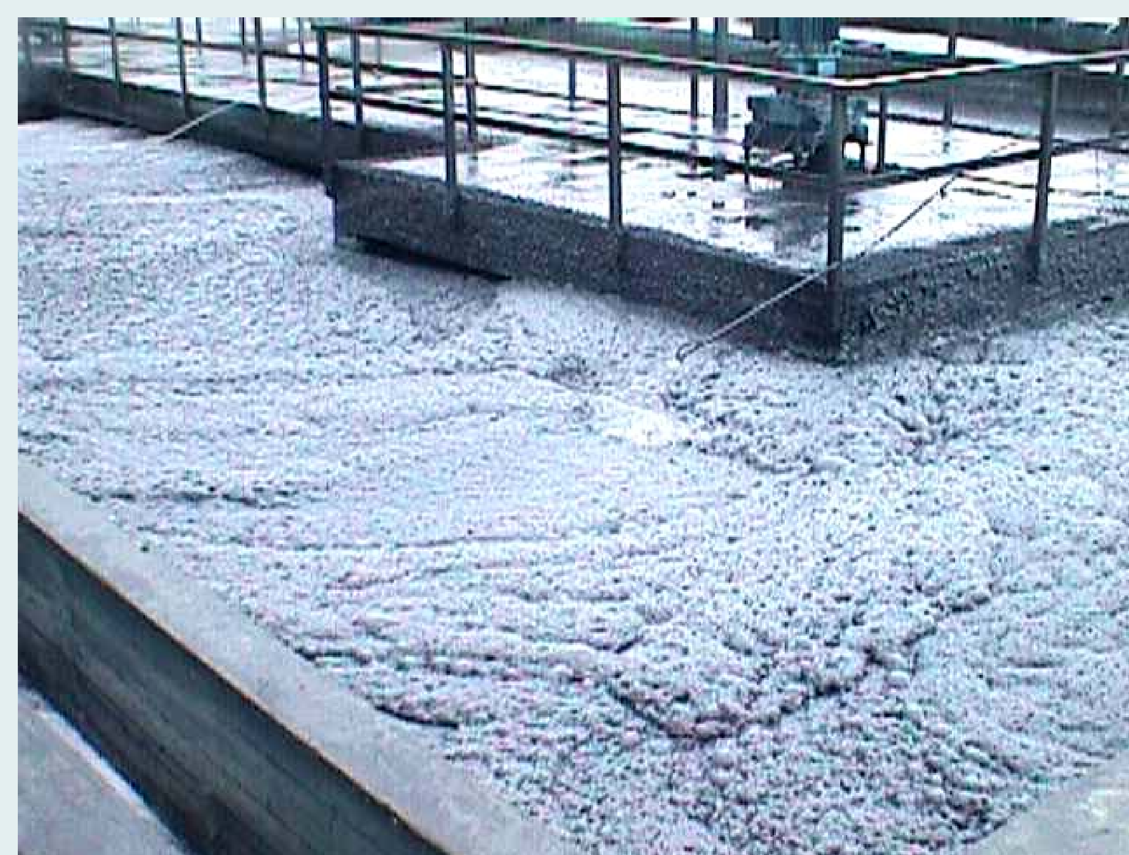
Doseamento de cloro na superfície dos tanques de arejamento - aspersão superficial
