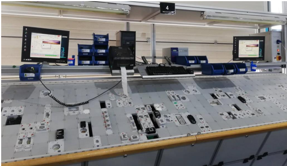
Figura 12 - Mesa de teste elétrico
