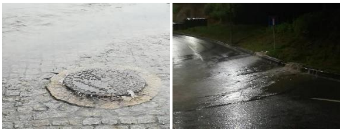
Ilustração 1 - Transbordamentos em redes de drenagem (caixa de visita e valeta)
