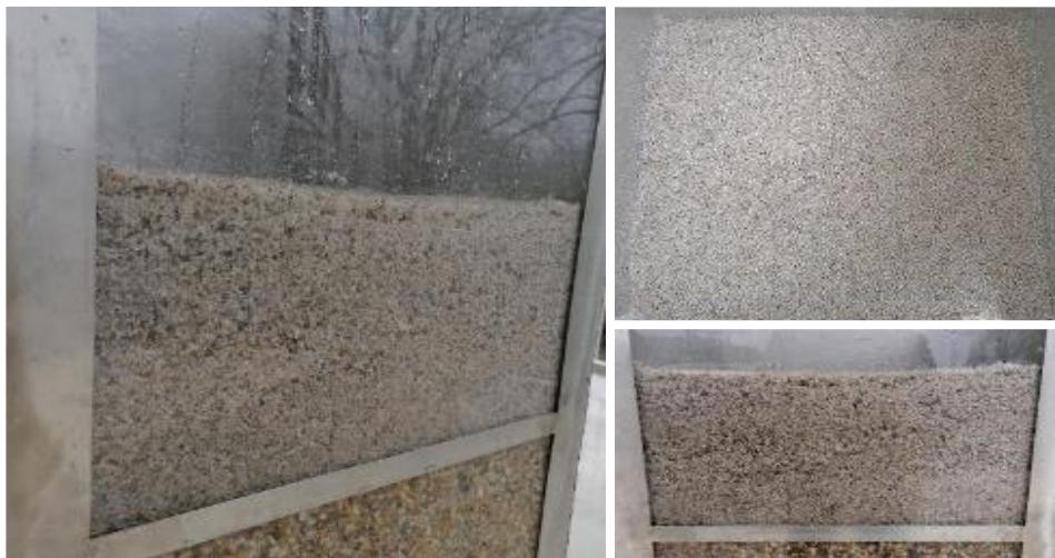
Ilustração 18 - Colocação da camada de 0,2 m de areia (lavada e peneirada) no meio poroso do canteiro de biofiltração convencional
