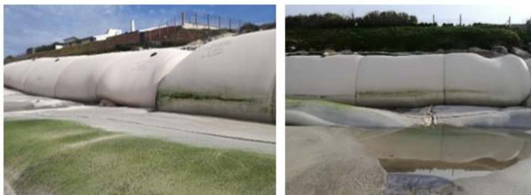
Figura 67 - Deformação dos cilindros geossintéticos como consequência da destruição da tela geotêxtil no trecho 5 (30.03.2017)
