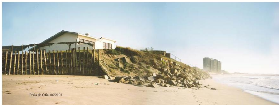
Figura 52 - Muro de proteção à habitação parcialmente destruído em junho de 2003 (Loureiro, 2006)
