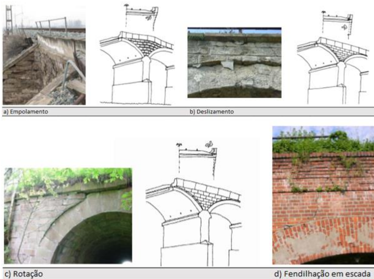
Figura 10 Anomalias Estruturais nos Tímpanos
