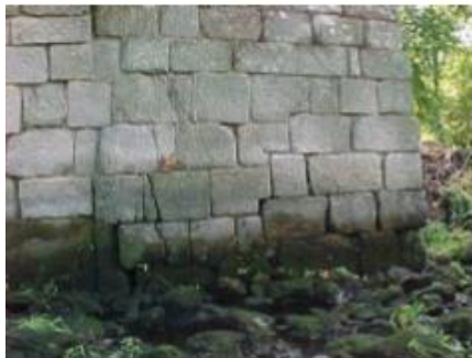
a) Presença de humidade por capilaridade
