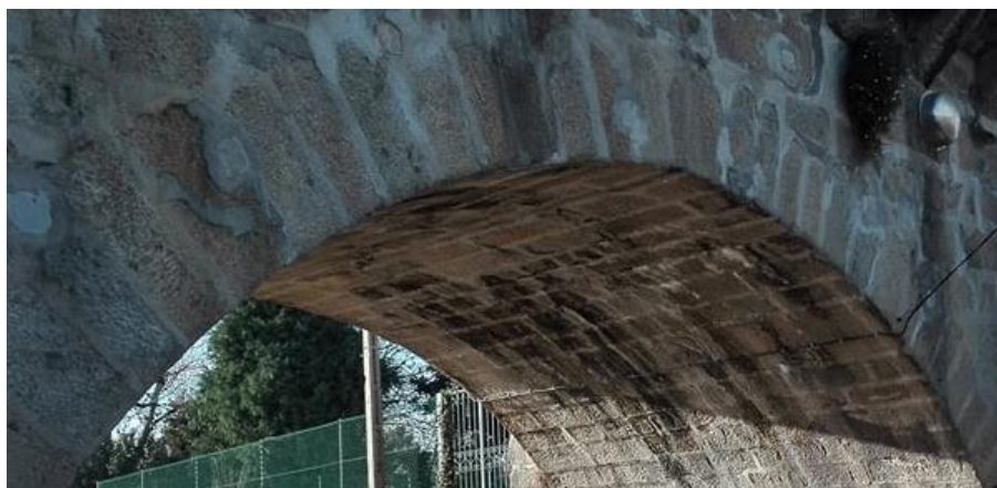
Figura 35 Escorrências generalizadas nos arcos
