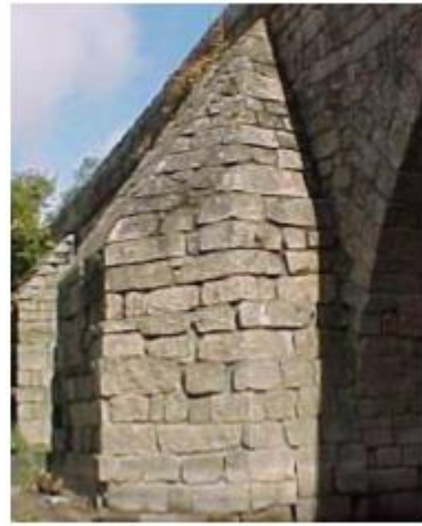
Perda de argamassa nas juntas
