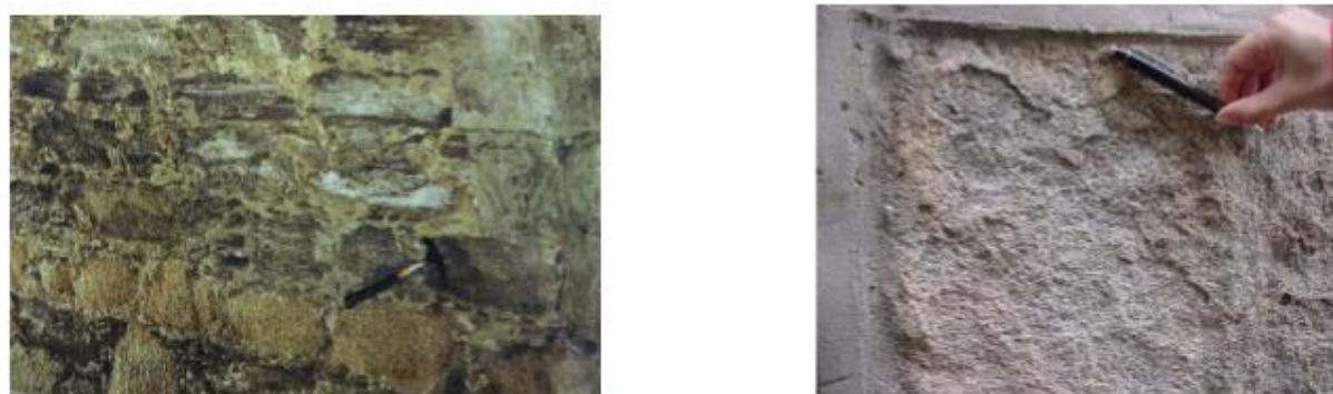
Desagregação da pedra
