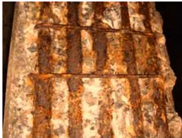
Figura 1 - Degradação do betão e corrosão nas armaduras[3]
