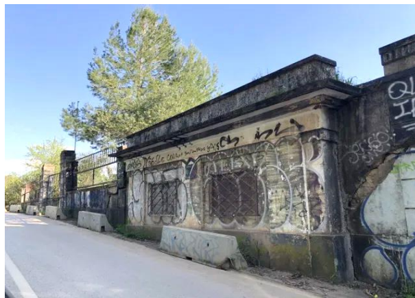
Figura 24: exterior da bateria
