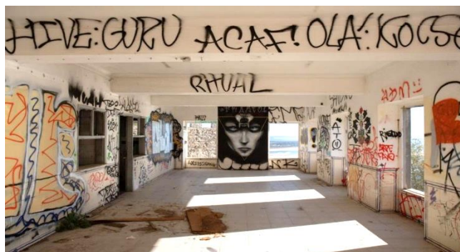
Figura 22: espaço interior vandalizado
