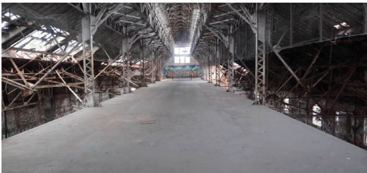
Fig.63 - Interior do armaz m frigor fica abandonada
