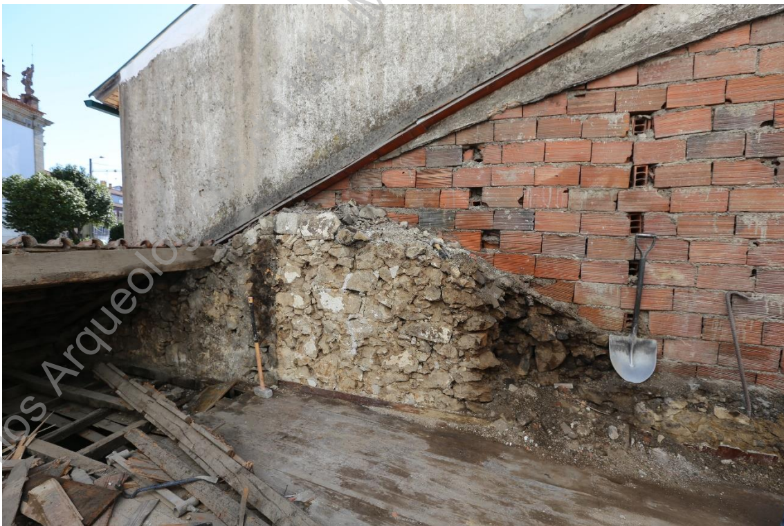
Foto 8 (IMG_5086) – Pormenor das paredes descascadas no piso superior.
