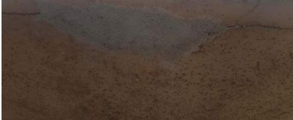
Figura 99 - Fissuração ao nível do pavimento de uma das varandas
