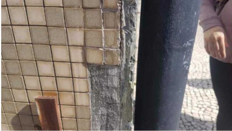
Figura 85 - Destacamento do revestimento cerâmico e oxidação das armaduras de pilar
