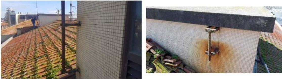
Figura 82 - Destacamento do revestimento cerâmico e oxidação dos elementos metálicos de fixação na caixa de escadas
