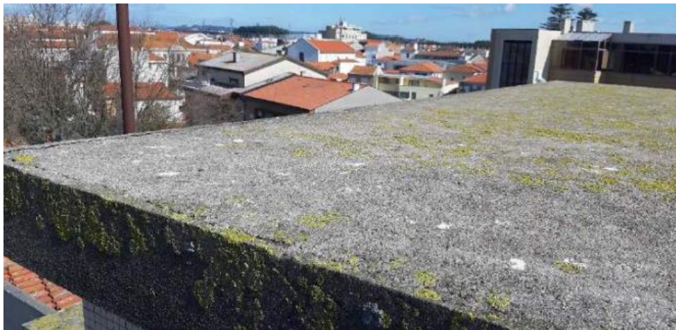
Figura 84 - Presença de fissuração nos bordos da laje de topo da caixa de escadas
