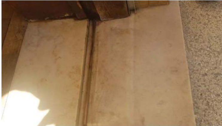
Figura 92 - Ausência de pendente de escoamento em soleira de janela
