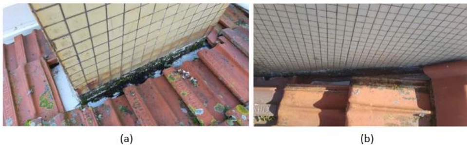
Figura 77 - Deterioração dos rufos da cobertura - (a) Na envolvente de uma chaminé; (b) Na envolvente da parede da caixa de escadas
