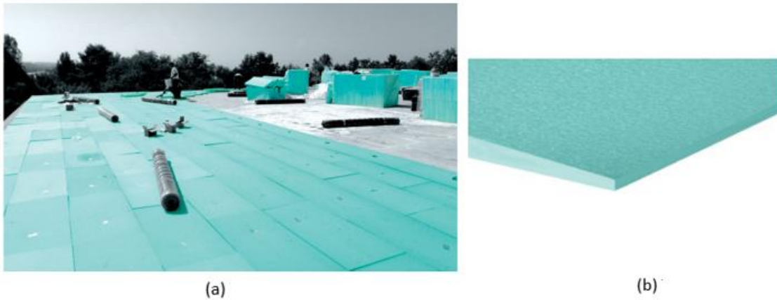
Figura 42 - Isolamento térmico em cobertura plana; (a) Colocação em obra; (b) Pormenor placa XPS lisa (reproduzido de (Fibran, 2020))
