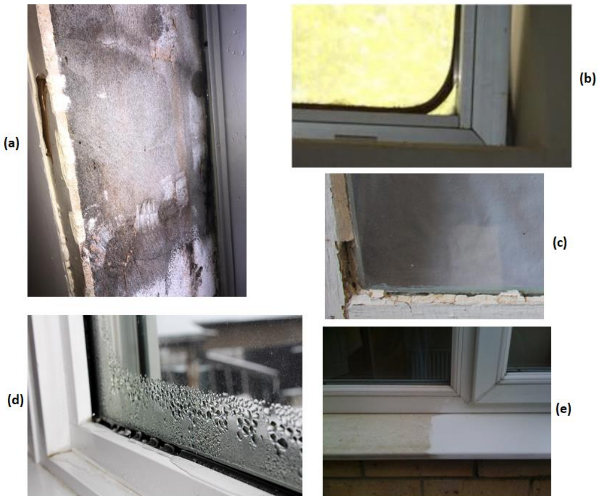
Figura 68 – Patologias em envidraçados; (a) Infiltração pela parede junto ao envidraçado (deterioração guarnições de madeira); (b) Má execução de cordão de estanquidade (reproduzido de (A. J. C. dos Santos, 2012)); (c) Desprendimento da massa de vidraceiro (reproduzido de (Cox, 2022)); (d) Condensações derivadas do elevado coeficiente de transmissão térmica dos caixilhos de alumínio (reproduzido de (Window Resource, 2022)); (e) Descoloração em caixilharia de PVC (reproduzido de (Traditional Painter, 2014))
