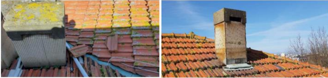
Figura 80 - Presença de fissuras e destacamento do revestimento cerâmico
