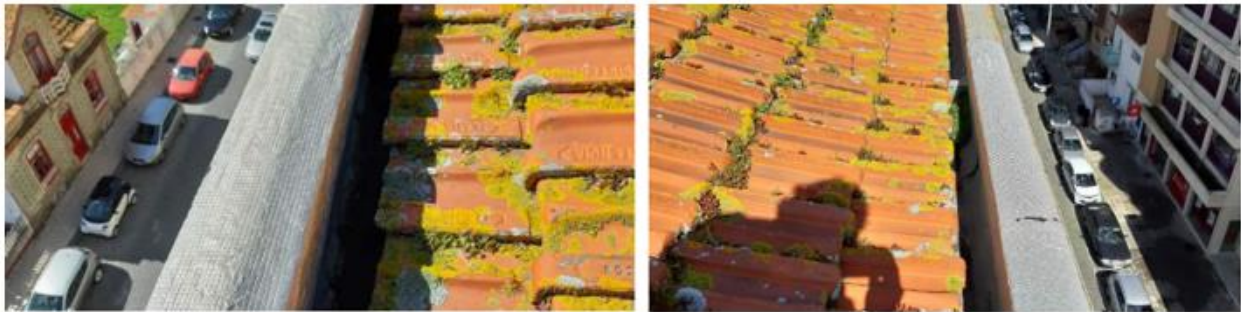
Figura 78 - Degradação da impermeabilização dos caleiros
