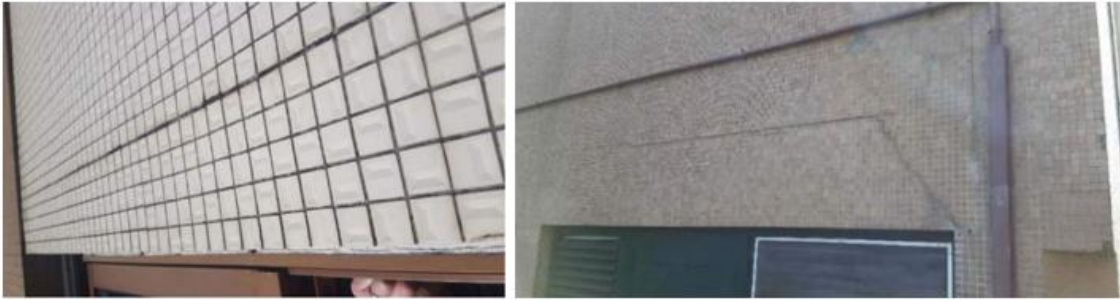
Figura 87 - Fissuração dos revestimentos cerâmicos e das juntas de preenchimento
