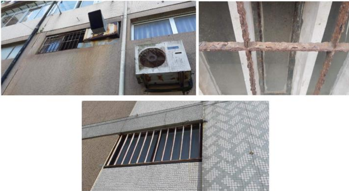
Figura 90 - Oxidação e corrosão de vários elementos metálicos fixados à fachada
