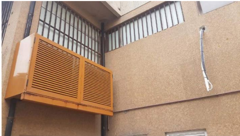
Figura 89 - Furo para passagem de tubagens desprotegido e sem conformidade com projeto
