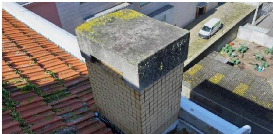
Figura 79 - Degradação dos materiais e acumulação de verdete e sujidade
