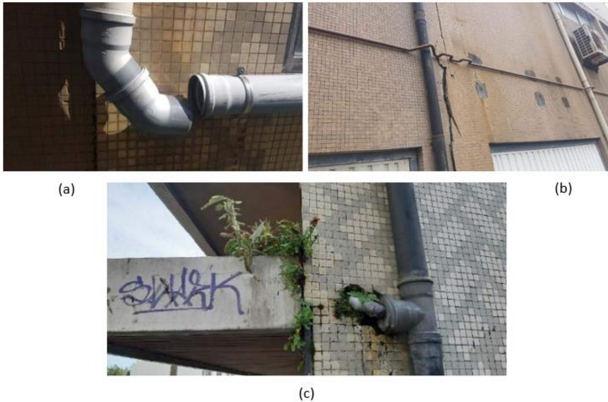
Figura 91 - (a) Tubo de queda desencaixado; (b) Tubagem de gás oxidada e degradada; (c) Tubo de queda com acessórios degradados e inadequados
