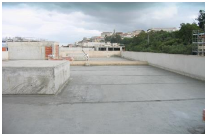
Figura 33 - Camada de forma em betão leve de cobertura plana (reproduzido de (“Sistema SOTECNISOL - Betão Celular,” 2012))
