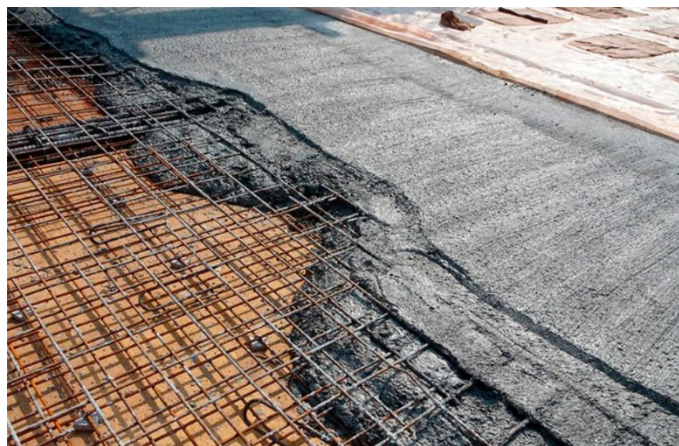
Figura 32 - Estrutura em betão armado de cobertura plana (reproduzido de (Características de Las Losas de Concreto Armado, 2019) )
