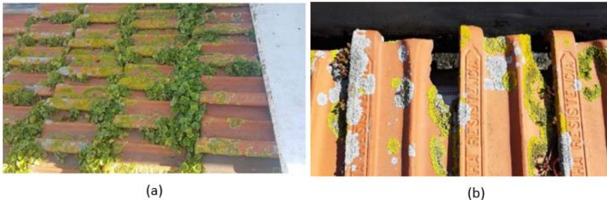
Figura 75 - Patologias no revestimento da cobertura - (a) Presença acentuada de vegetação parasitária; (b) Acumulação de sujidade e telhas partidas
