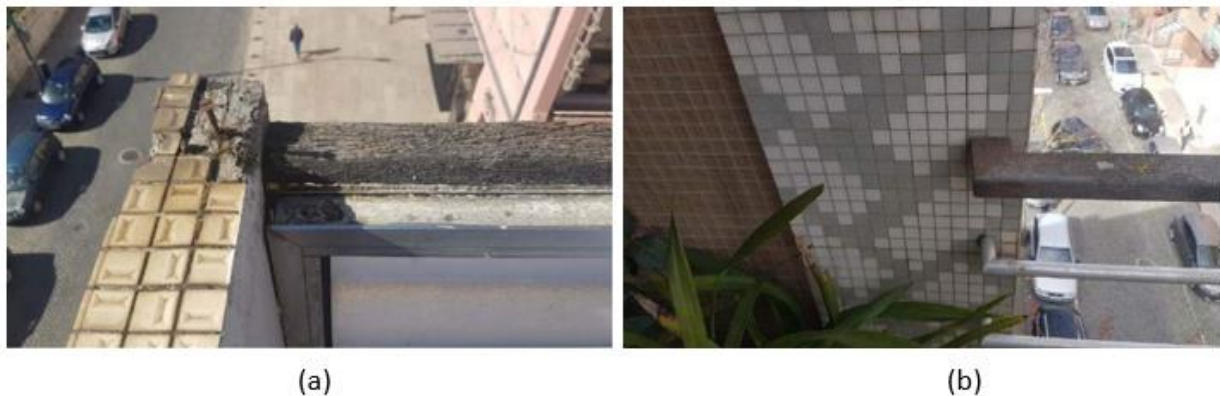
Figura 97 - Patologias nas guardas das varandas - (a) Madeira degradada e ausência de parte do material de revestimento; (b) Oxidação do gradeamento metálico
