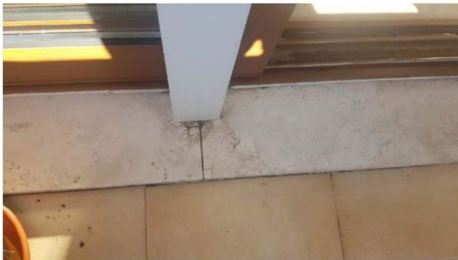
Figura 93 - Fissuração em soleira de janela com acesso para varanda
