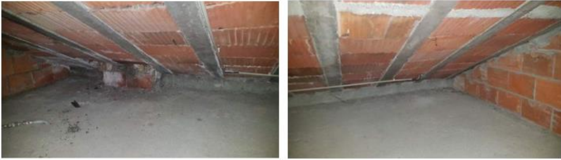
Figura 76 - Ausência de isolamento térmico no desvão da cobertura
