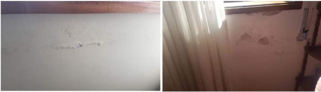
Figura 94 - Sinais de infiltrações na envolvente de vãos envidraçados
