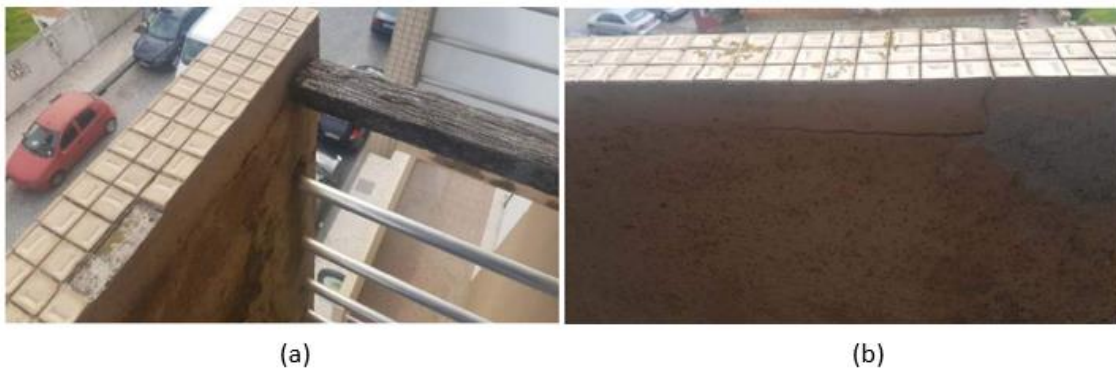
Figura 98 - Patologias nos muretes das varandas - (a) Destacamento do revestimento cerâmico; (b) Descasque da pintura aplicada sobre o reboco
