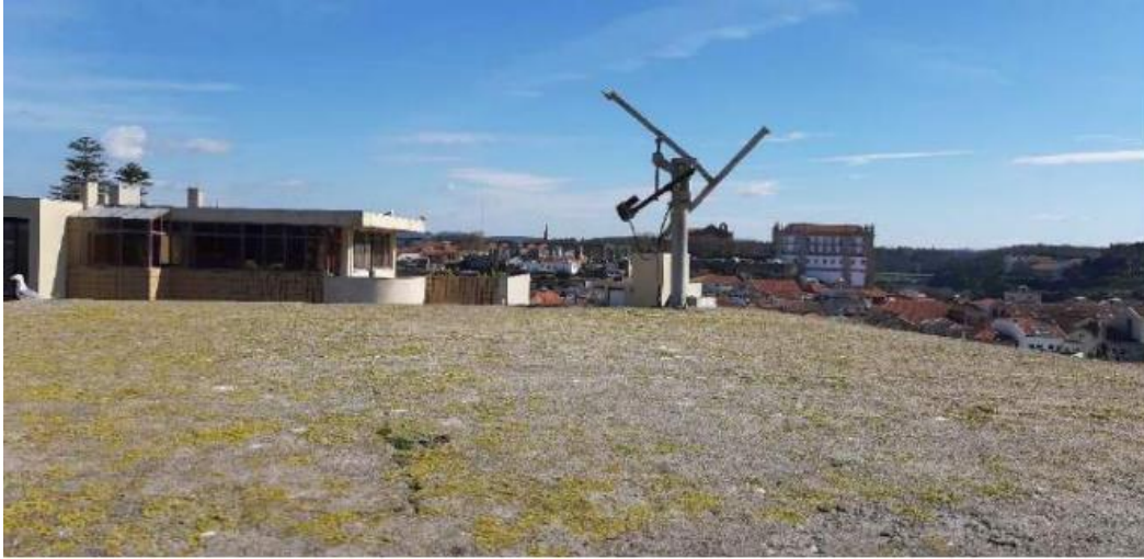
Figura 83 - Presença de musgo e degradação da superfície de betão
