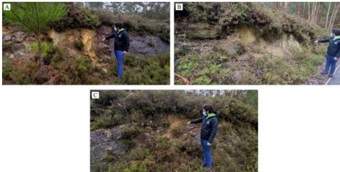
Figura 4.3 – Levantamento fotográfico das zonas de interesse do talude do acesso (dezembro, 2021).
