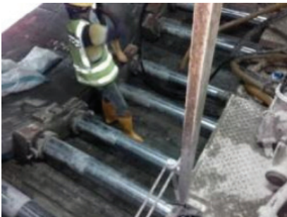
Fig.4 - Proximidade de trabalhador a zona de montagem de aduelas
