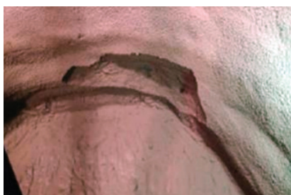
Fig.3 - troço de abóbada com queda de betão projetado
