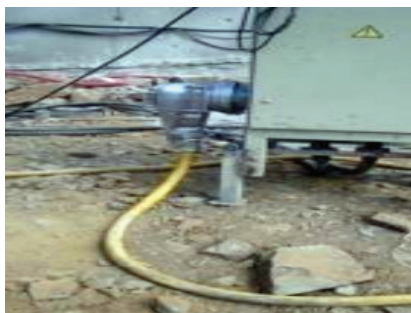
Fig.1 - cabo elétrico em pavimento de MEC
