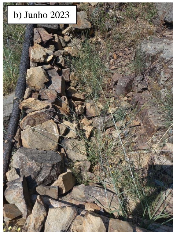
Figura 42. Local de monitorização 2 na 2ª visita em junho de 2023, após a implementação da medida de estabilização de emergência: a) vista a jusante da OCT; b) vista a montante da OCT
